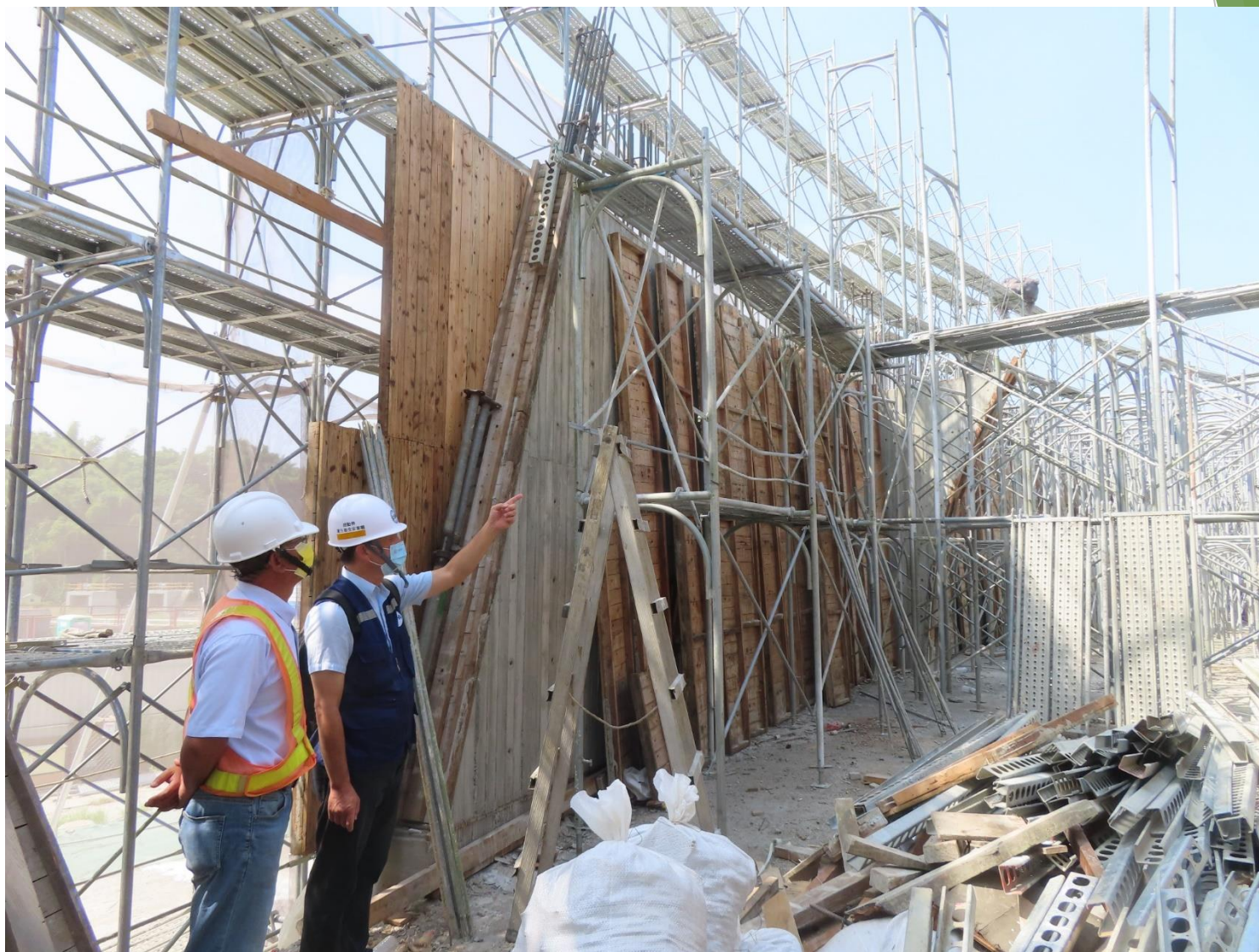
施工架組立未有上下設備-未設置安全母索供勞工勾掛安全帶-鳥嘴潭湖區管理中心工程
