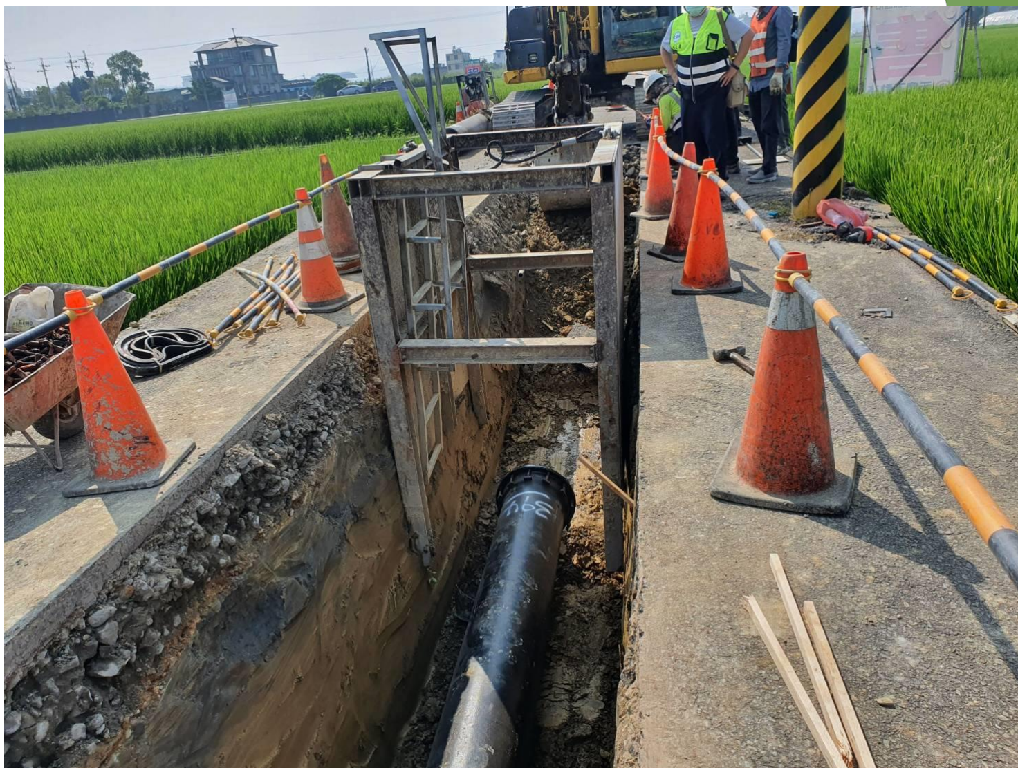
露天開挖作業場所設置擋土措施不足-自來水 送水管工程
