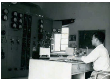
李振海在電廠控制室作業情形
